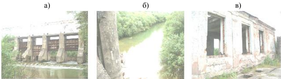
Рис. 2 – Стан гідроспоруд Новошицької МГЕС (р. Бистриця Тисменицька, Львівська обл.) до відновлення: а) вид на греблю з нижнього б'єфа; б) стан русла ріки у верхньому б'єфі; в) стан будівлі МГЕС
