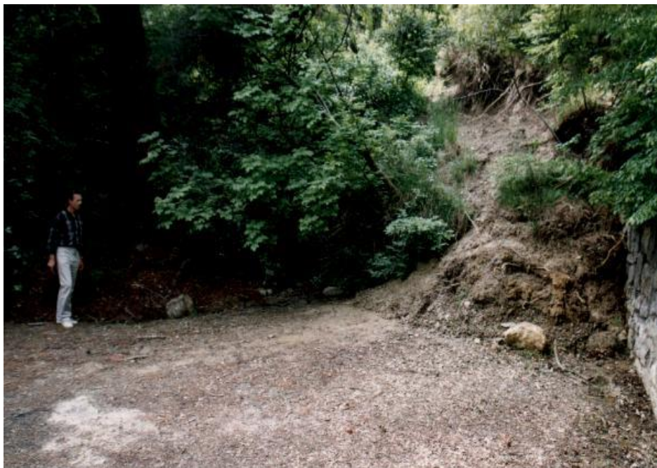
Рис. 4 – Розрізання дороги з огорожувальними підпірними стінами лівим бортом «Західного» зсуву
