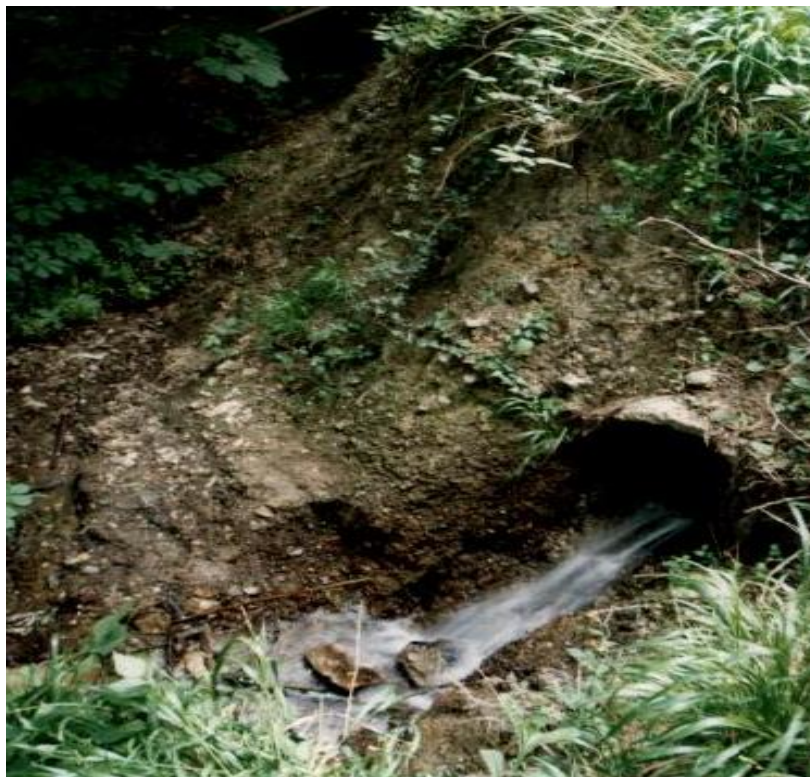
Рис. 6 – Зруйнована водовідвідна труба південної гілки дренажної галереї
